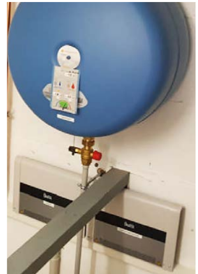
Un boîtier de régulation gère les 2 circuits de chauffage logements et la production d'eau chaude sanitaire, un autre gère le circuit de chauffage professionnel et la température de départ du réchauffeur de cuve, dont la gestion finale est assurée par un régulateur spécifique. La régulation est raccordée en online, permettant à l'utilisateur d'effectuer la programmation et la commande à distance de son système, et à l'installateur d'assurer à distance le suivi, la maintenance, les diagnostics et certains paramétrages.
