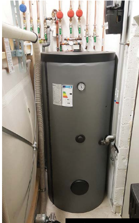
Le préparateur de 500 l a été logé au chausse-pied entre le silo et la paroi. Chaque départ d'ECS est doté d'un sous-compteur.
